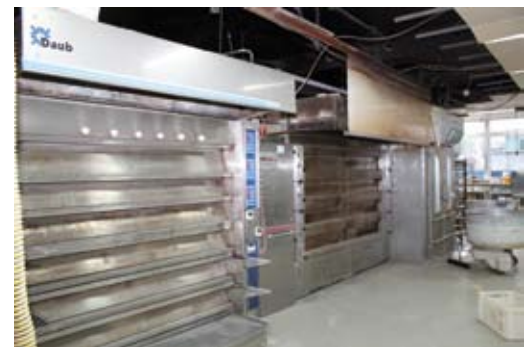
Der Daub Backmeister ersetzte einen durch einen Brand beschädigten WP Matador. Auch der Elektroofen wurde umgerüstet.
